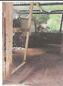
Foto 4: Implemantación de piso torta de concreto (Salón de usos Múltiples). Por que no hay piso, y en epoca de lluvia es muy difícil trabajar por que se hace mucho lodo.
